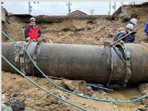
＜地震による送水管の損傷＞
